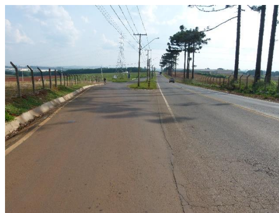
Figura 87: Sistema de drenagem localizada na Avenida Pedro Wosgrau. Autor: Orbienge, 2023.
