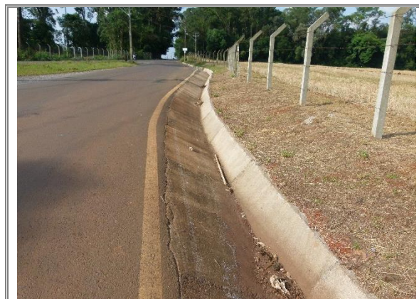
Figura 86: Sistema de drenagem localizada na Avenida Pedro Wosgrau. Autor: Orbienge, 2023.
