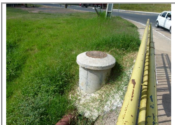
Figura 52: Poço de Visita localizado no cruzamento da Rua Valério Ronchi com a Rua Rio Verde. Autor: Orbienge, 2024.
