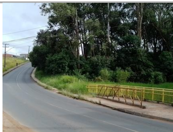
Figura 90: Calçada sem manutenção margeando a Estrada Sebastião Bastos. Autor: Orbienge, 2024.
