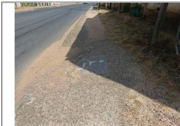
Figura 89: Calçada e sinalização de rampa de acesso em estado precário. Autor: Orbienge, 2024.
