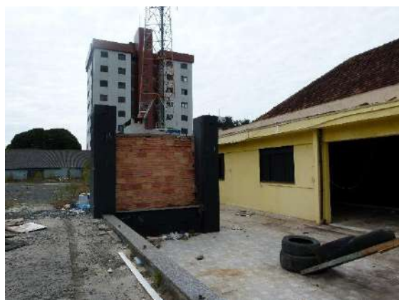
Figura 4: Edificações existentes no lote de implantação do empreendimento. Autor: ORBIENGE, 2023.
