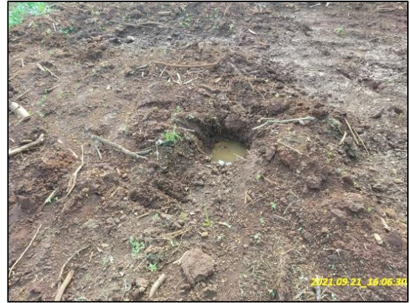
Aparecimento de possível novo piping a jusante da área do empreendimento
