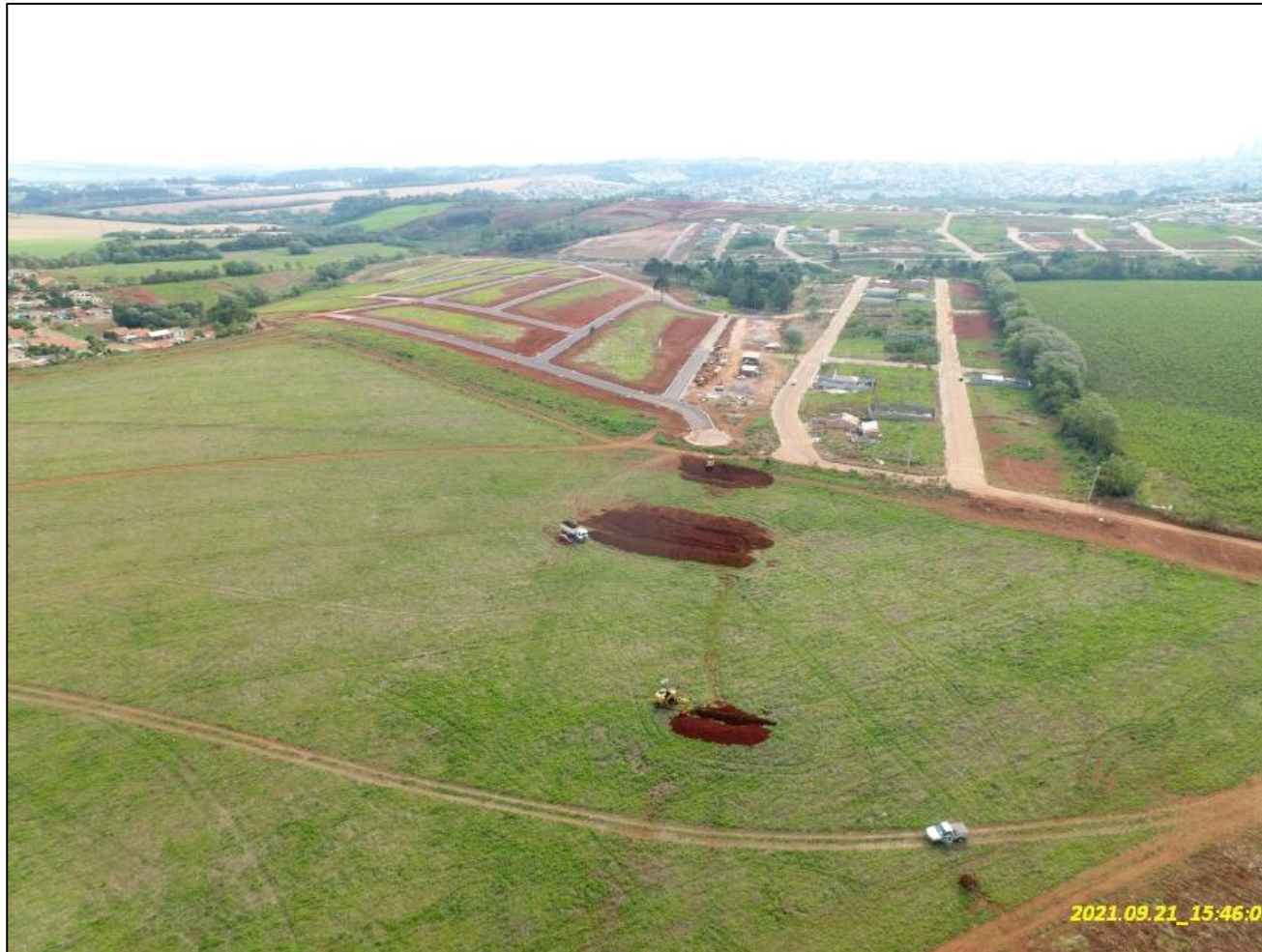
Disposição das trincheiras de inspeção ao longo do talvegue – vista para jusante
