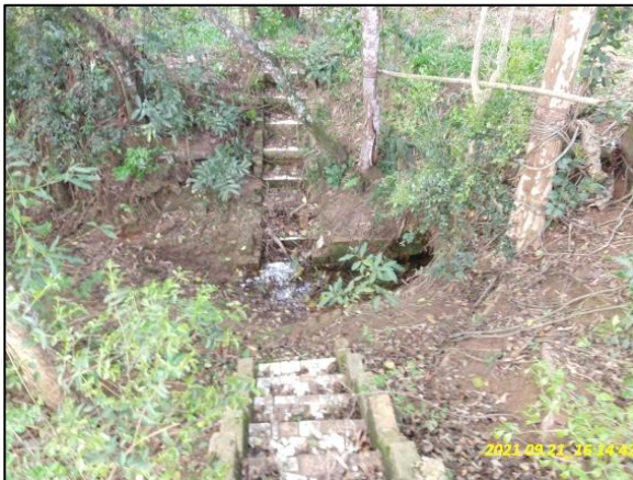
Afloramento de duto subterrâneo a jusante da área do empreendimento
