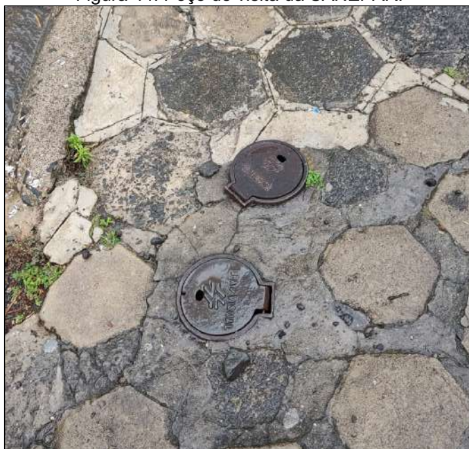
Figura 44. Poço de visita da SANEPAR.
