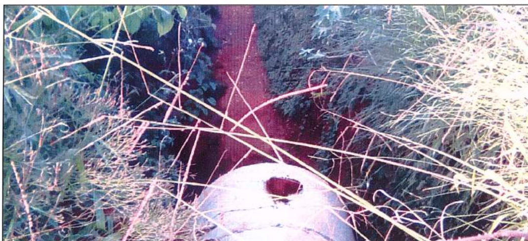
Fotografia 08: Manilha que deságua no interior do terreno avaliado.
