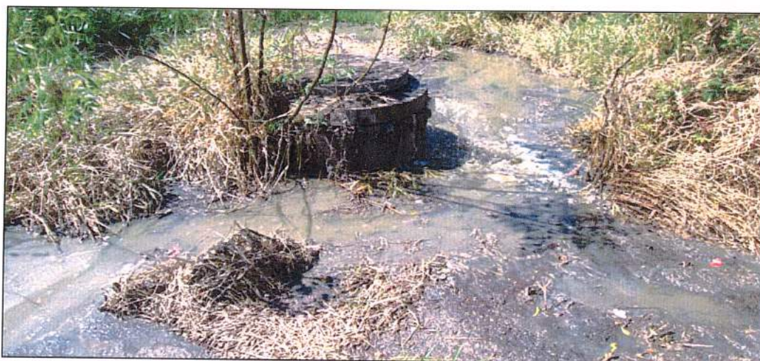
Fotografia 10: Caixa de passagem vertendo esgoto in natura no solo.
