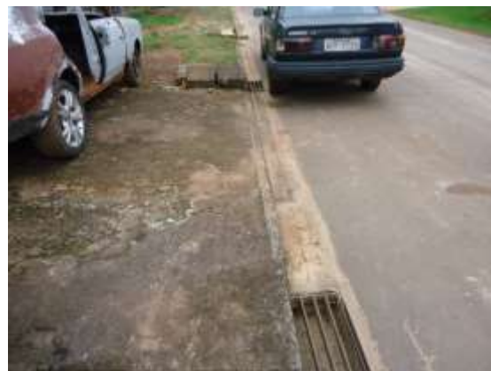
Foto 20 - Bocas de lobo encontradas na via próximo ao cruzamento com a Rua Melvin Jones.
