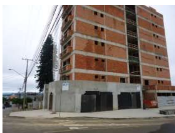
Foto 5 - Edifício Residencial sendo construído na Rua José Pierri esquina com a Av. Melvin Jones.
