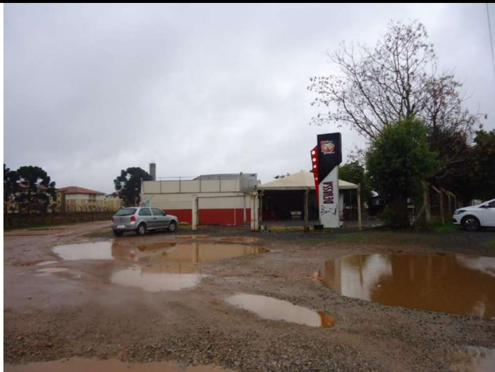
Foto 5 – O trecho da Av. General Carlos Cavalcanti, próximo da rotatória de acesso à Rua Valério Ronchi, não possui calçada.
