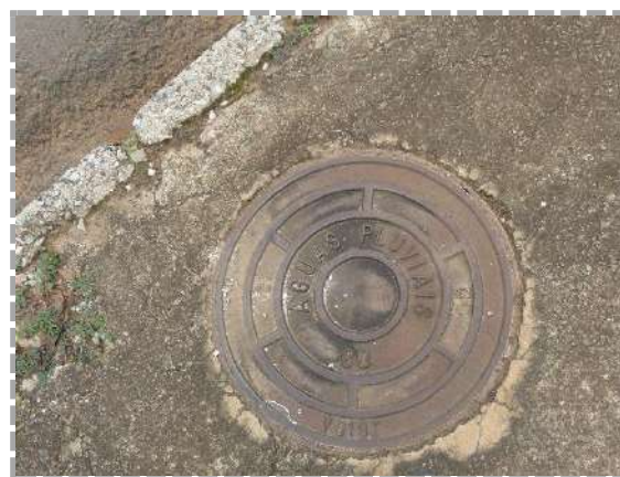
Figura 75: Poço de visita de galeria de águas pluviais localizado na Rua Cirema Becker esquina com a Rua Artur Denck. Autor: ORBIENGE, 2023.
