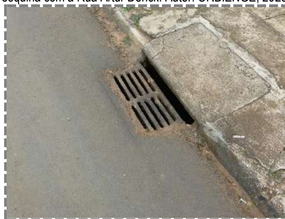
Figura 77: Boca de lobo localizado na Rua Cirema Becker (sentido bairro-centro) no trecho em frente ao empreendimento. Autor: Orbienge, 2023.
