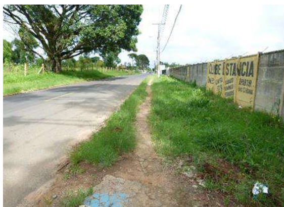
Figura 103: Início da Rua Cirema Becker, pavimentação asfáltica boa, rampas de acessibilidade e calçada sem conservação. Autor: ORBIENGE, 2022.
