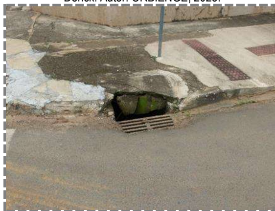
Figura 76: Boca de lobo localizado na Rua Cirema Becker esquina com a Rua Artur Denck. Autor: ORBIENGE, 2023.
