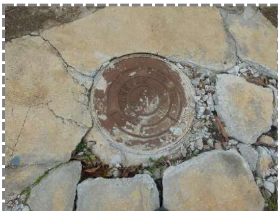
Figura 74: Poço de visita da rede de esgoto localizado na Rua Cirema Becker (sentido bairro-centro) no trecho em frente ao empreendimento. Autor: ORBIENGE, 2023.
