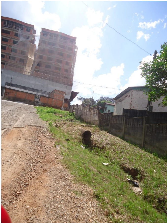
Figura 69: Manilha de descarte de águas pluviais ao fundo do lote do empreendimento Residencial Mauá.
