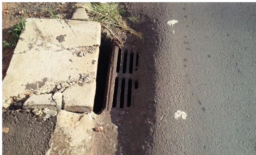
Figura 66: Boca de lobo com a tampa de concreto danificada.
