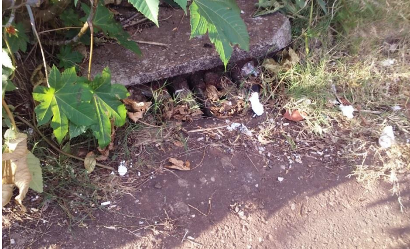
Figura 67: Boca de lobo com grandes quantidades de resíduos, obstruindo a passagem de água.
