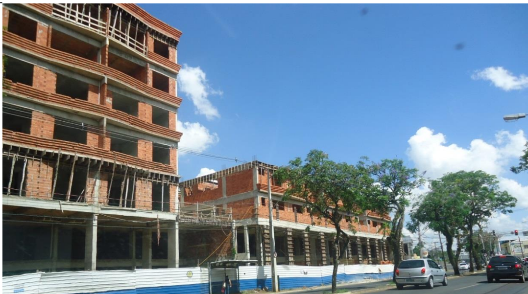
Figura 4: Vista da obra do empreendimento – Av. Visconde de Mauá. Fonte: Master Ambiental, 2016.
