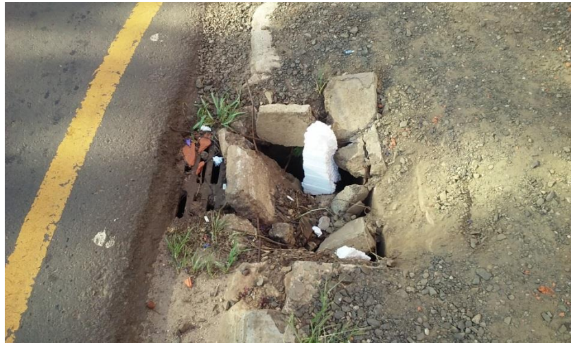
Figura 65: Boca de lobo na Av. Visconde de Mauá danificado.
