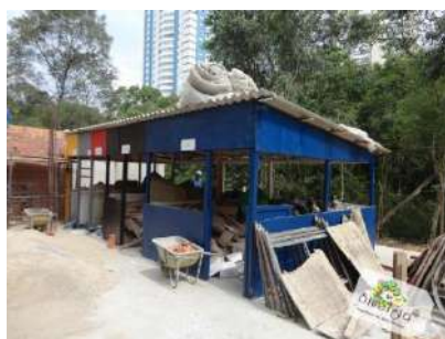
Foto 34 - Modelo de baia para o armazenamento de resíduos. Fonte: Obra do Edifício Eurobusiness (2015).
