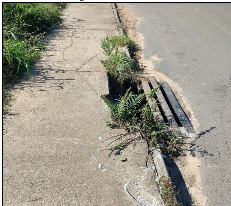
Figura 43. Boca de lobo.
