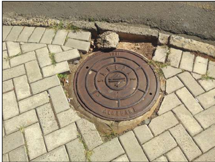
Figura 42. Poço de visita da SANEPAR.
