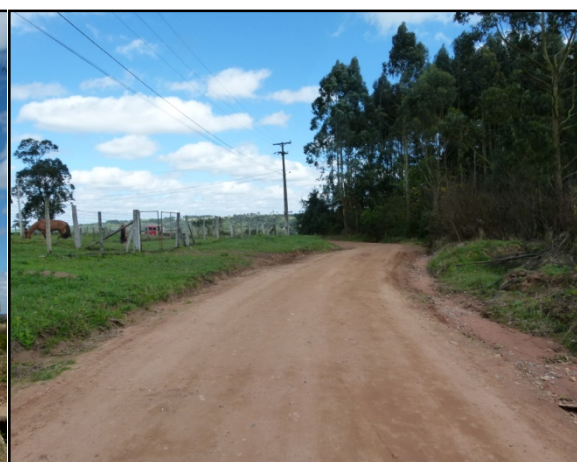
Figura 14 - Rua Arno Wolf sem pavimentação.
