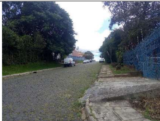
Figura 72: Situação do passeio da Rua Braulina Carneiro de Quadros, lado ímpar, em direção à Rua Darcy Pelissari.
