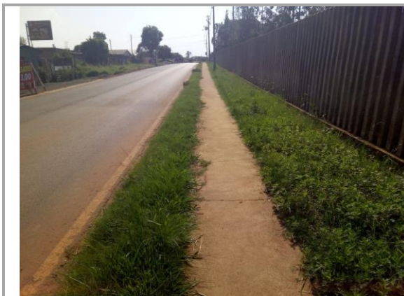
Figura 60: Situação da calçada da Rua Prof. Gabriel de Paula Machado, no trecho em frente ao empreendimento em direção a Al. Nabuco de Araújo.
