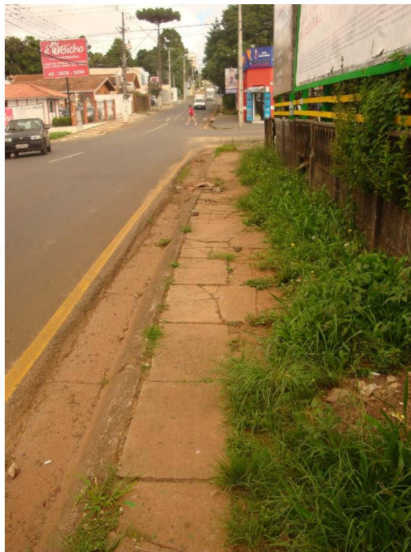
Figura 46: Calçada deteriorada na Rua Emílio de Menezes Fonte: A autora (2017)
