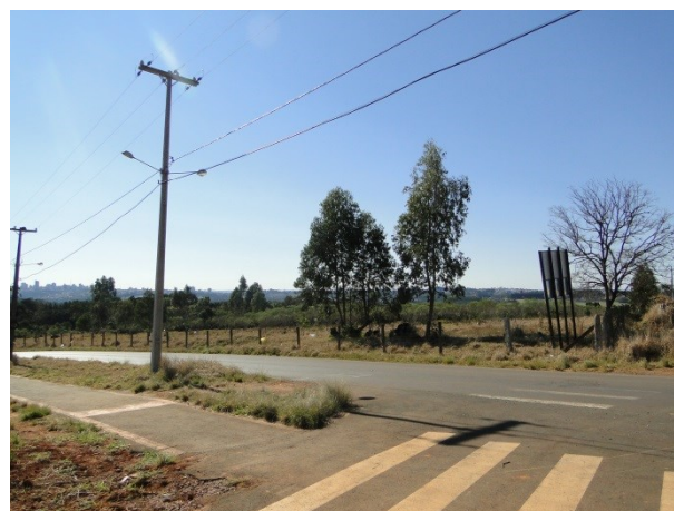
Cabeamento de Telefonia Fixa - Rua Antônio Burgardt
