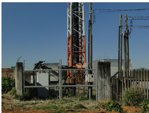
Torre de Telefonia Móvel Instalada a aproximadamente 1650 metros do empreendimento Fonte: Indicador Florestal (2016)
