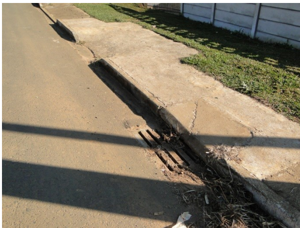
Sistema de Coleta de Águas Pluviais – Rua Buraco do Padre
