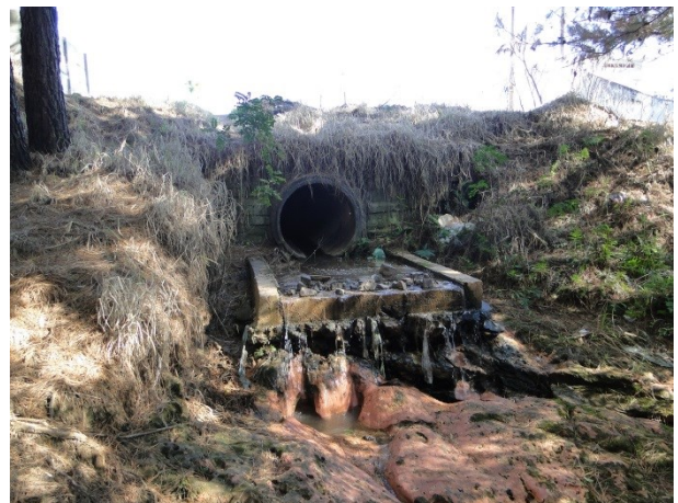
Ponto de Lançamento de Águas Pluviais no Córrego da Ronda
