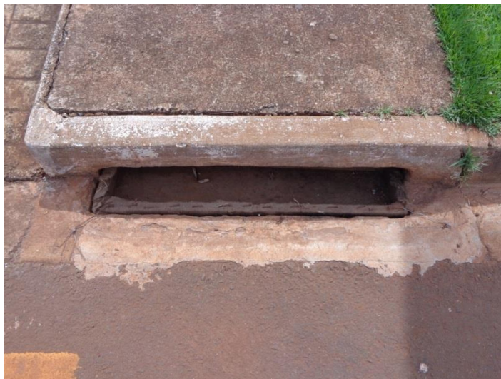
Figura 67: Sugestão de instalação de Bidin na boca de lobo para coletar material particulado. Fonte: Master Ambiental
