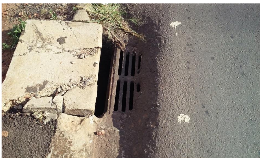
Figura 65: Boca de lobo com a tampa de concreto danificada.
