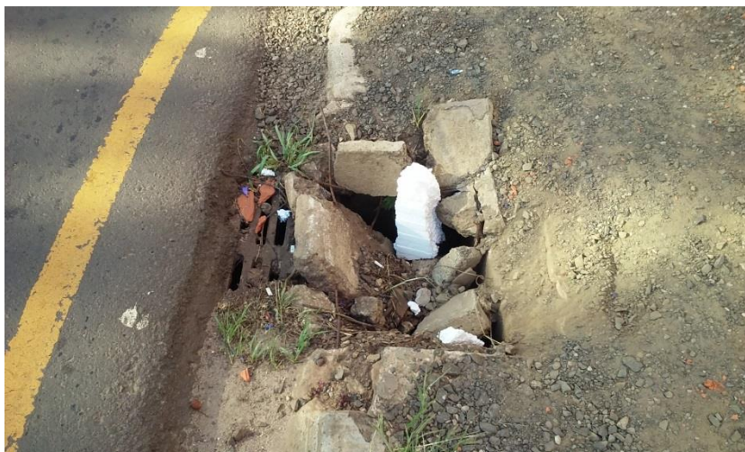
Figura 64: Boca de lobo na Av. Visconde de Mauá danificado.
