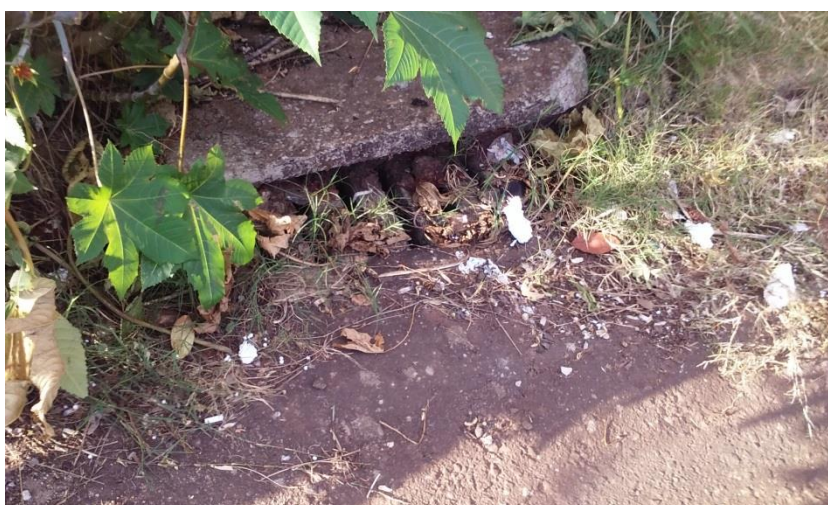
Figura 66: Boca de lobo com grandes quantidades de resíduos, obstruindo a passagem de água.
