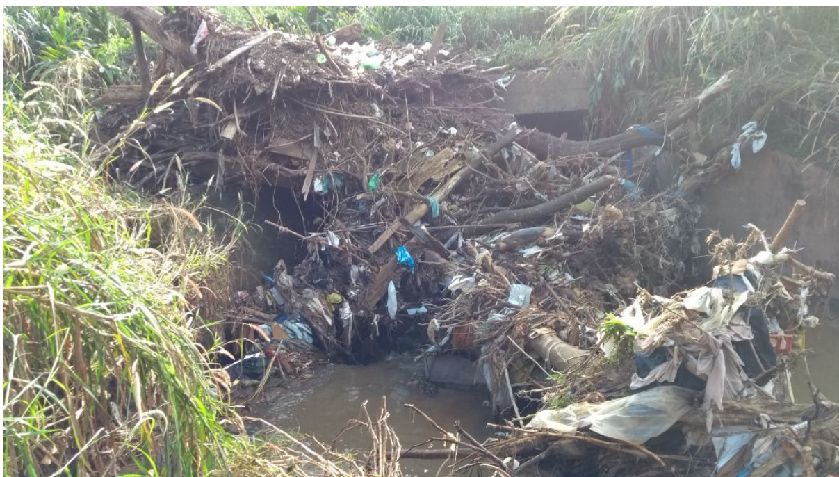
Foto 10 – Vista a montante da passagem do Pilão de Pedra sob a via férrea Seção totalmente tomada pela retenção de lixo e galhos
