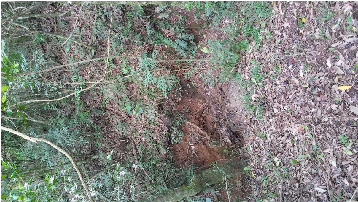
Foto 03 – Vista de canal erosivo seco situado entre as estacas 26 e 28 da Rua 01
