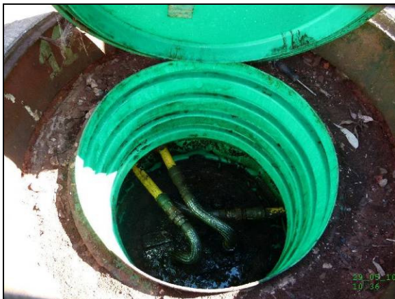
Detalhe dos tanques
