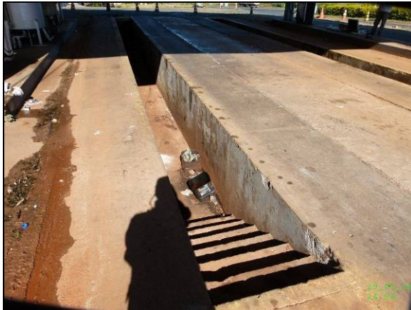
Detalhe das valas de lubrificação
