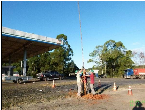
Sondagem ST01 – vestígio de óleo
