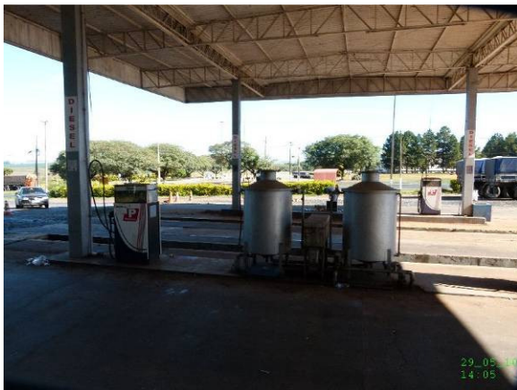
Detalhe do filtro de diesel
