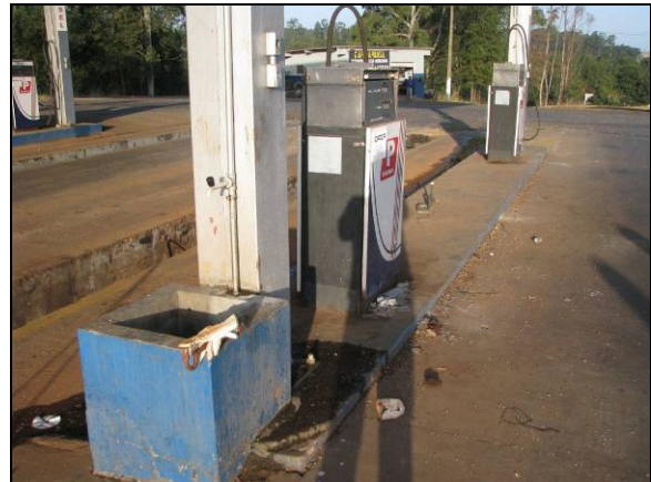
Detalhe das bombas de diesel
