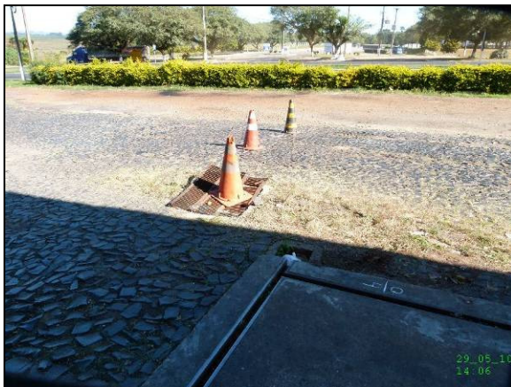
Detalhe do sistema de drenagem superficial
