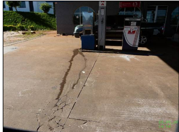
Detalhe da condição do piso
