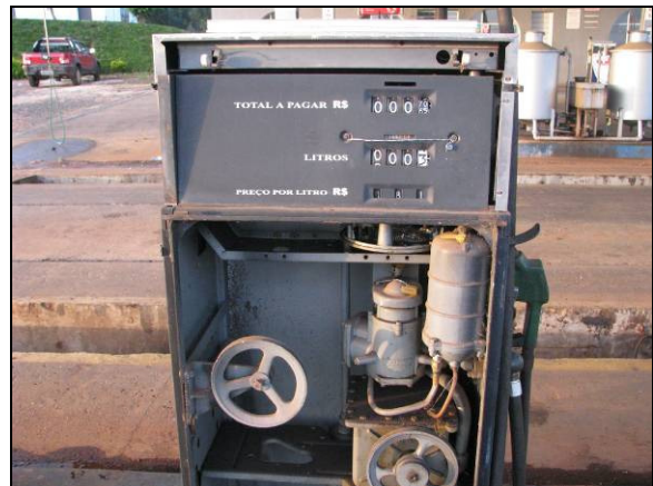
Detalhe da bomba de diesel
